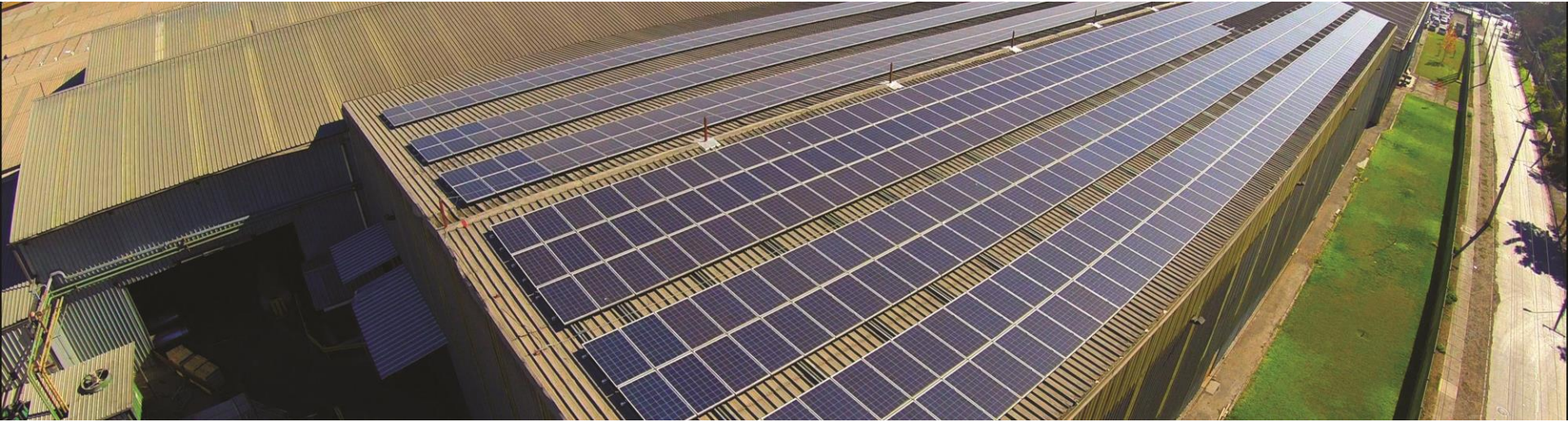
CINTAC Solar – Planta fotovoltaica on roof
