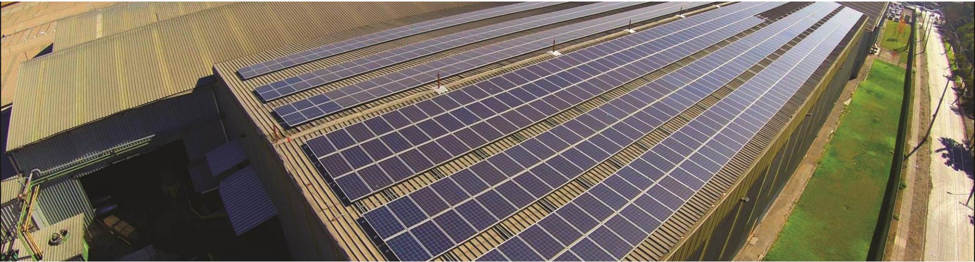
CINTAC Solar – Planta fotovoltaica on roof
